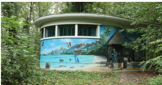
Der Horizontalfilterbrunnen der Berliner Wasserbetriebe
